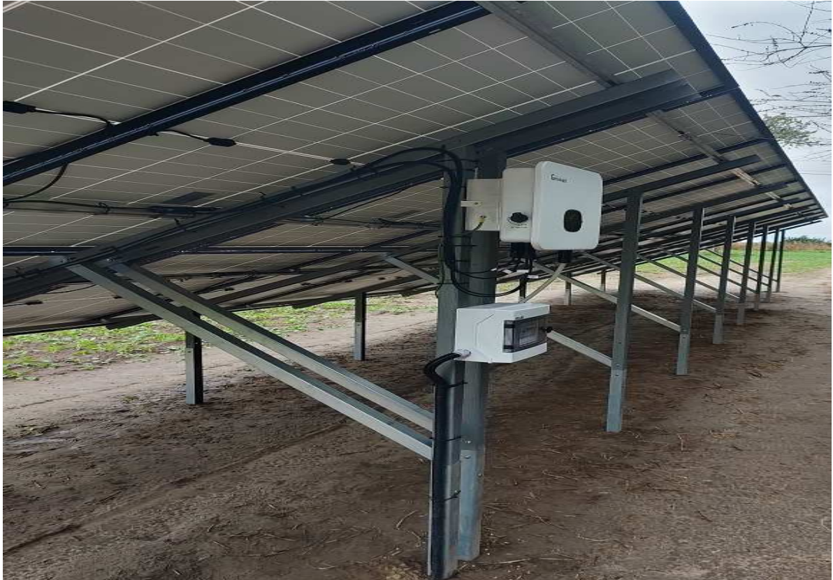
Rycina 2. Instalacja zamontowana pod konstrukcją paneli (widok na inwerter). Źródło: archiwum energoZysk sp. z o.o.
