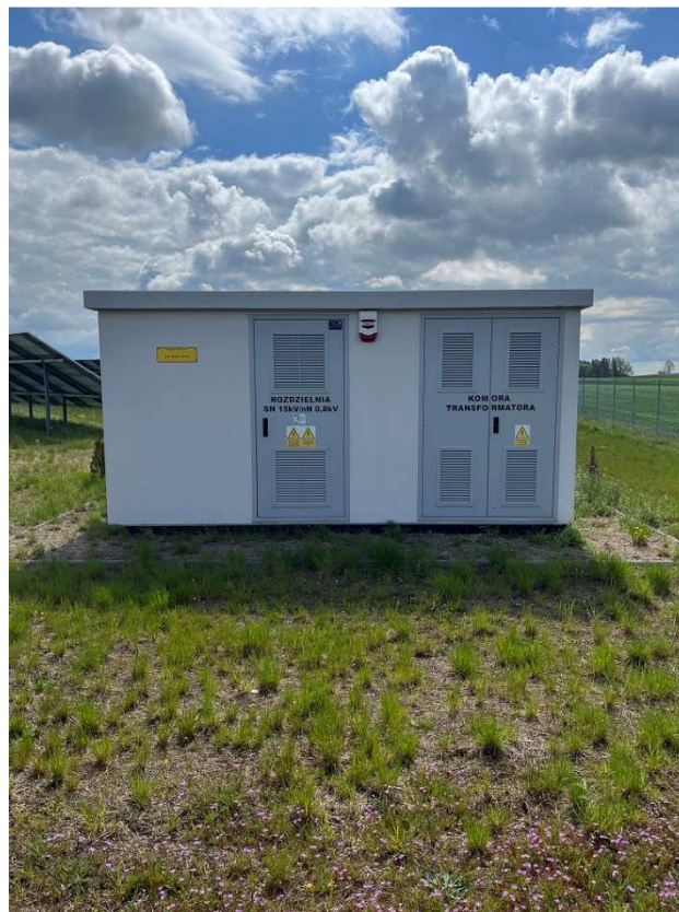
Rycina 3. Kontenerowa stacja rozdzielająca wraz z transformatorem Źródło: archiwum energoZysk sp. z o.o.
