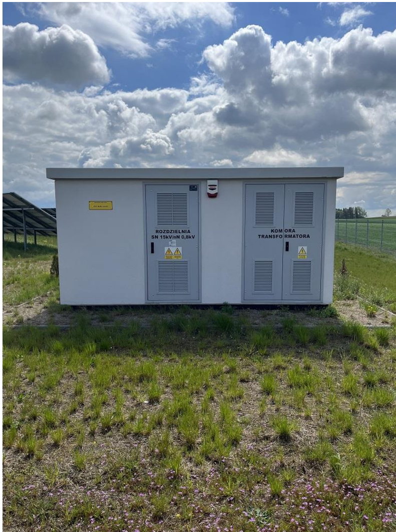
Fot. Transformator. Źródło: archiwum firmy Energozysk
