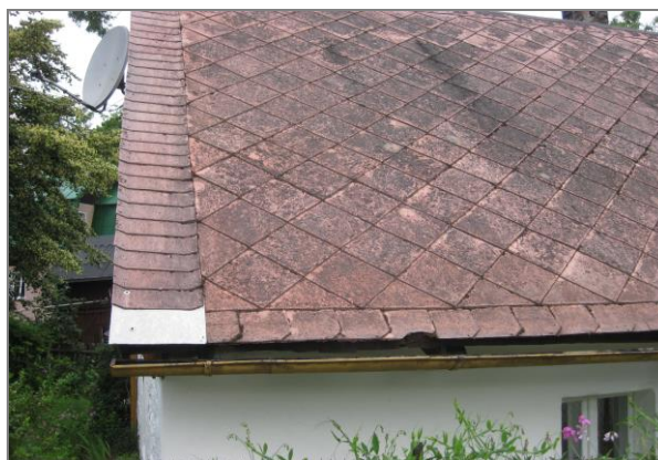
Fot. 2 Płyty azbestowo-cementowe płaskie
