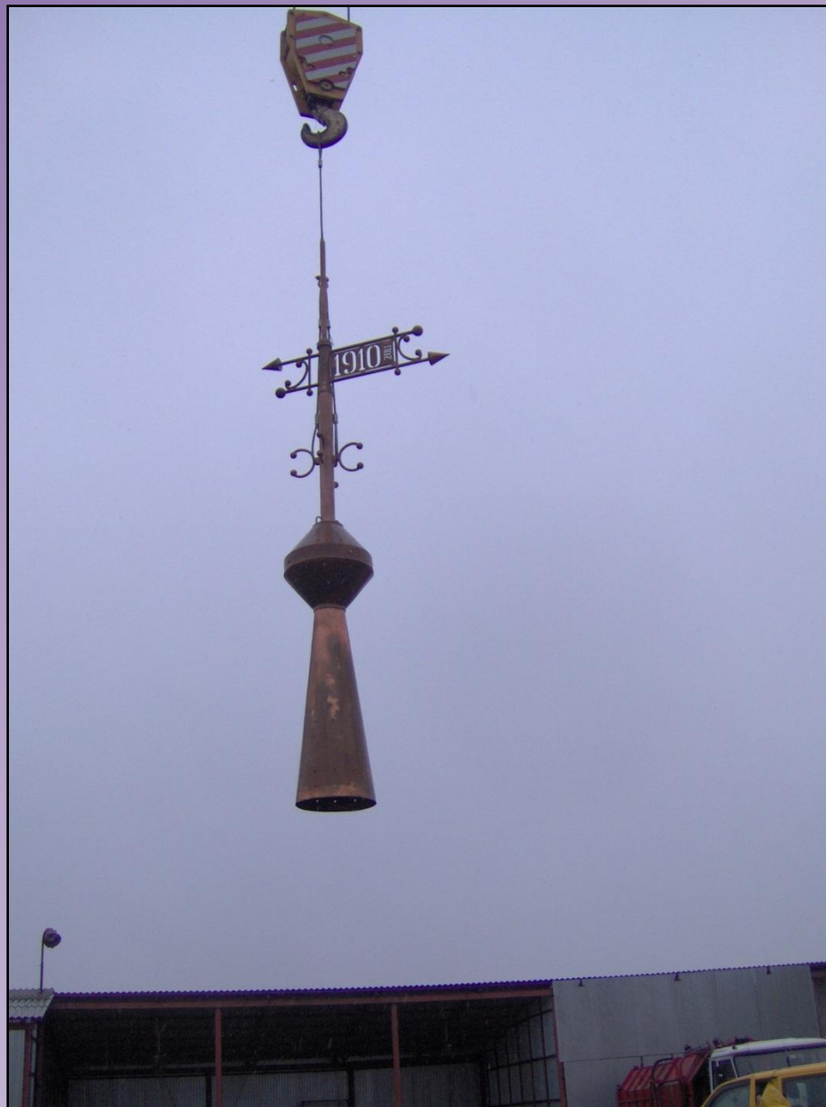
Fot. 37 Prace związane z montażem nowej iglicy wieży ciśnień (30.12.2011 r.) Autor: Piotr Orzeł
