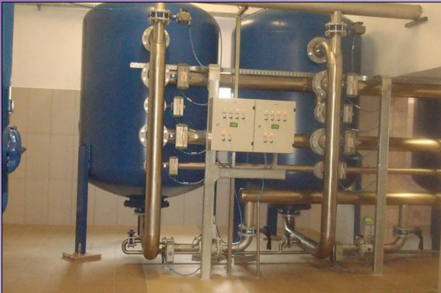
Fot. 46 Wnętrze hydroforni w Łobżenicy Źródło: Internet, 2012g
